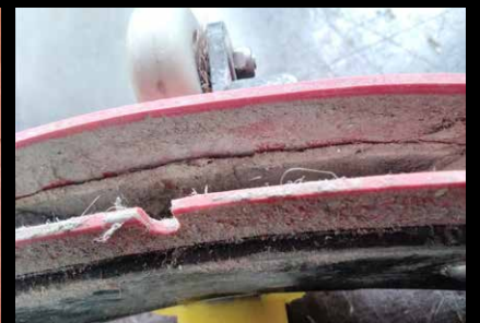
Zanieczyszczenie / zła konserwacja na codzień
