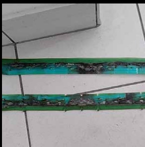
Zanieczyszczenie i odbarwienie od chemii
